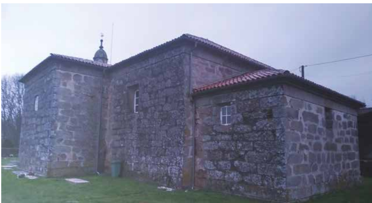
El tejado presentaba problemas de impermeabilización
