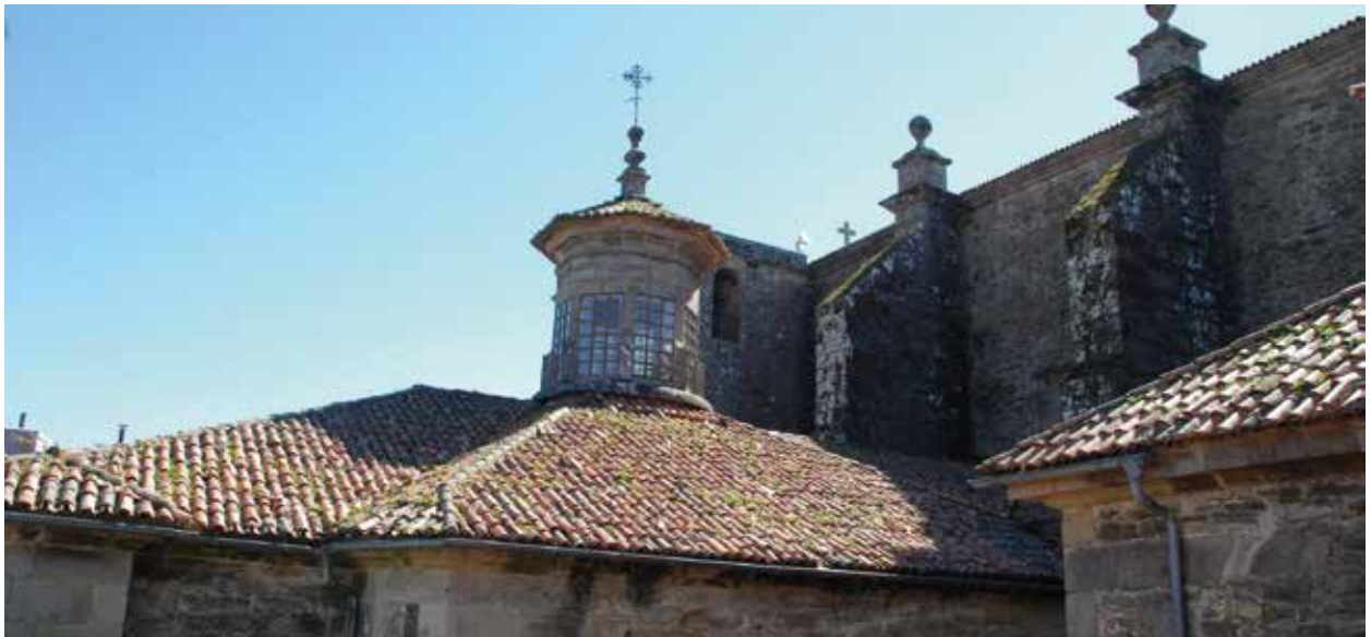
Las tejas están en muy mal estado
